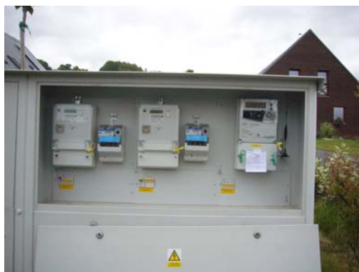
Obr.7 Měření spotřeby elektrické energie na patě domu
