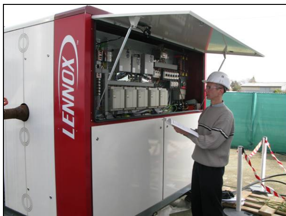
Obr. 4 Zprovoznění jednotky s čerpadlem s proměnlivým průtokem (Zdroj: Lennox)
