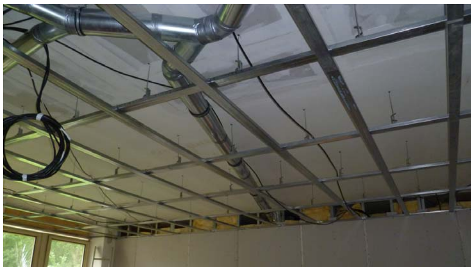
Obr. 2 Rozvody vzduchotechniky v prostoru mezistropu.
