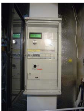
Obr.8 Měření elektrické energie pro IZT
