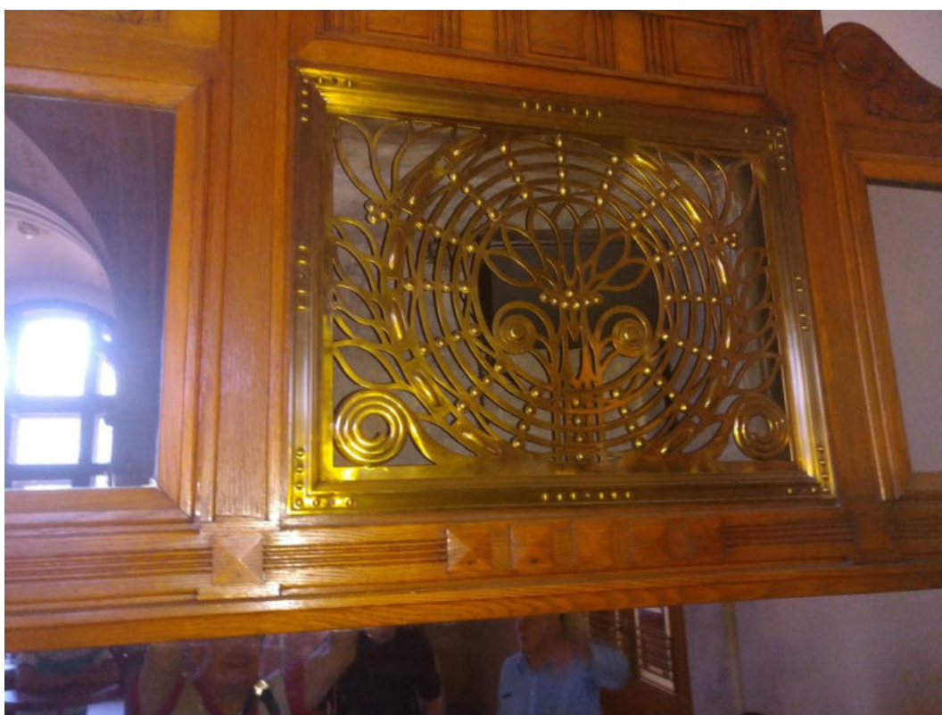
Přívodní mřížka ve foyer ve 2.NP
