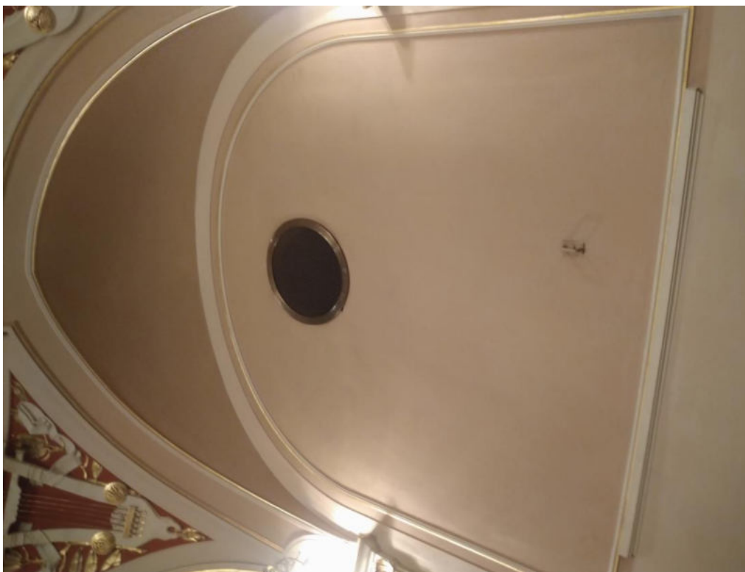
Odsávací vyústka z loží na balkóně hlediště
