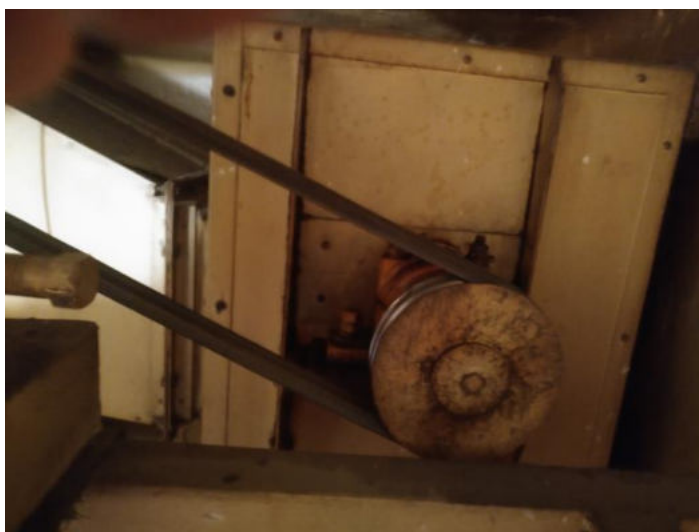
Ventilátor původní klimatizace jeviště
