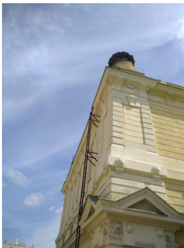
Pohled na výdech z komínu plynové kotelny
