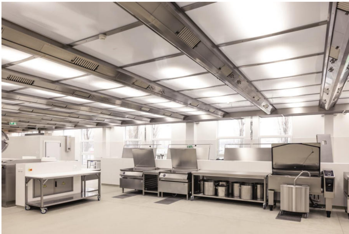
Obr. 3 Pohled (2) na interiér centrální varny s větracím a klimatizačním stropem TPV
