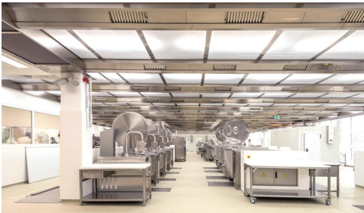
Obr. 2 Pohled (1) na interiér centrální varny s větracím a klimatizačním stropem TPV
