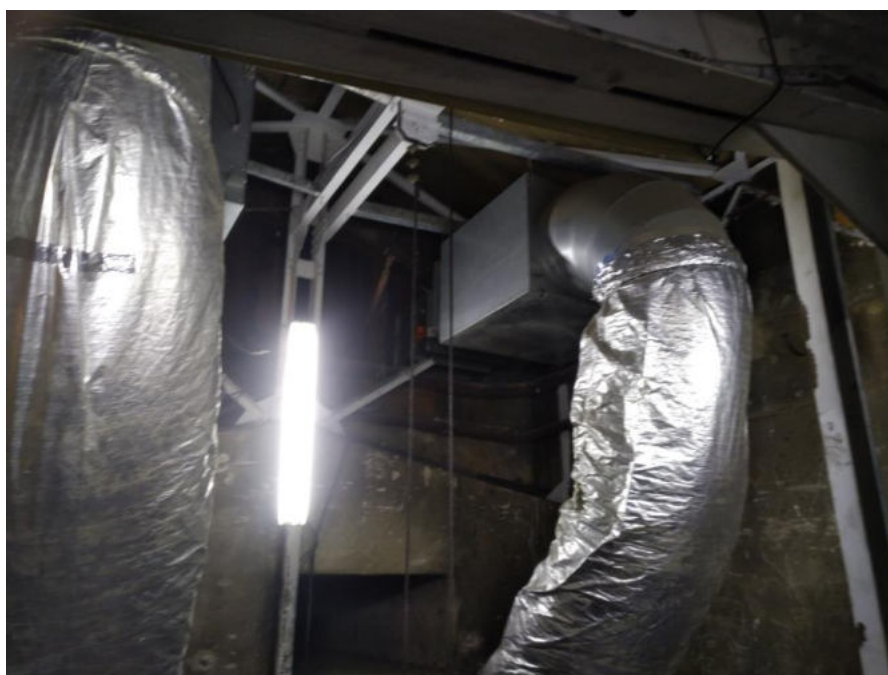
Odsávací ventilátory lustru hlediště
