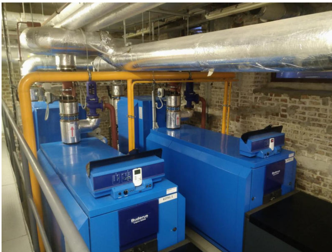
Pohled na kotle Buderus v plynové kotelně
