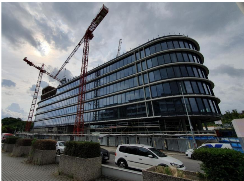
Obr. 2 Roztyly Plaza – Dodávka 25 vzduchotechnických jednotek s průtoky od 750 m 3 /h po 37800 m 3 /h
