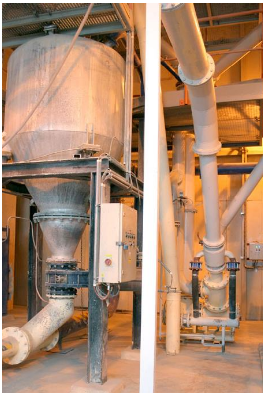
Obr. 7 Teplárna Kladno – komorový a průtokový podavač
