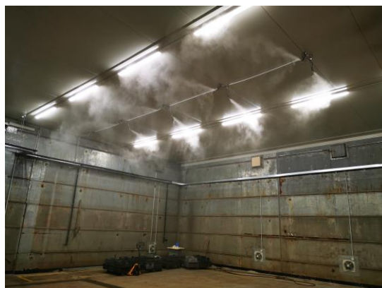
Zvlhčovací vysokotlaký systém, dimenzován pro relativní vlhkost 98–99 % při teplotě 5–8 °C připraven pro sklad lesních sazenic
