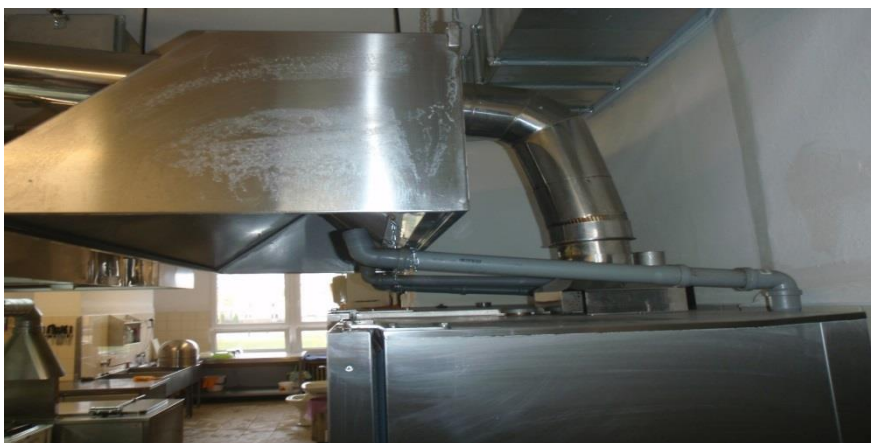
Obr. 3 Odtahy vodních par od konvektomatů byly zaústěny do odsávání VZT a filtry před rekuperačním výměníkem byly v cyklech silně smáčeny a opět usušeny. V krátké době byly nepropustné viz. obr. 5
