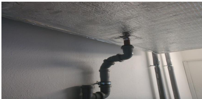
Obr. 4 Odvod vyprodukovaného kondenzátu z potrubí sání vzduchu z kuchyně byl odváděn do kanalizace jen tímto vtokem DN 32 mm zaústěným bez zápachové uzávěrky do splaškové kanalizace. Chybí otvor pro čištění a kontrolu stavu v potrubí.
