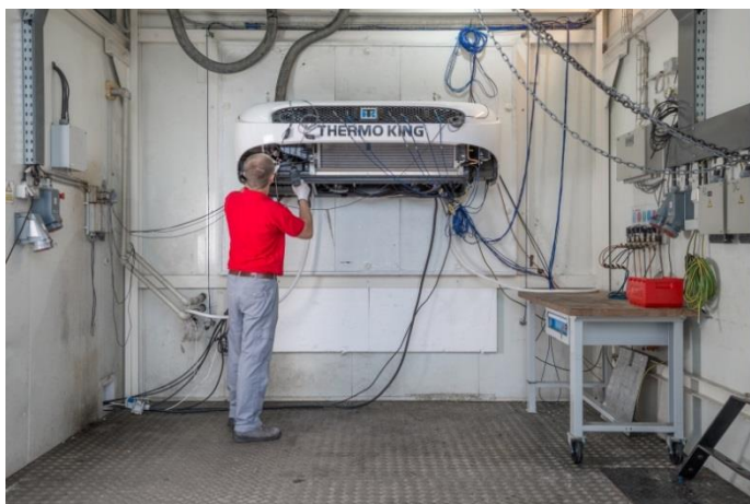
Obr. 6 Měření chladicího a topného výkonu chladicí jednotky
