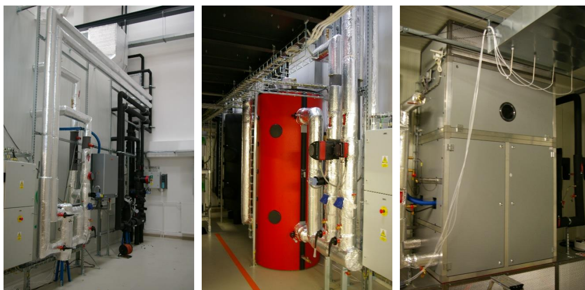
Obr. 2 Zleva – směšovací okruhy, akumulací nádrže, rekondiční jednotka „Indoor“
