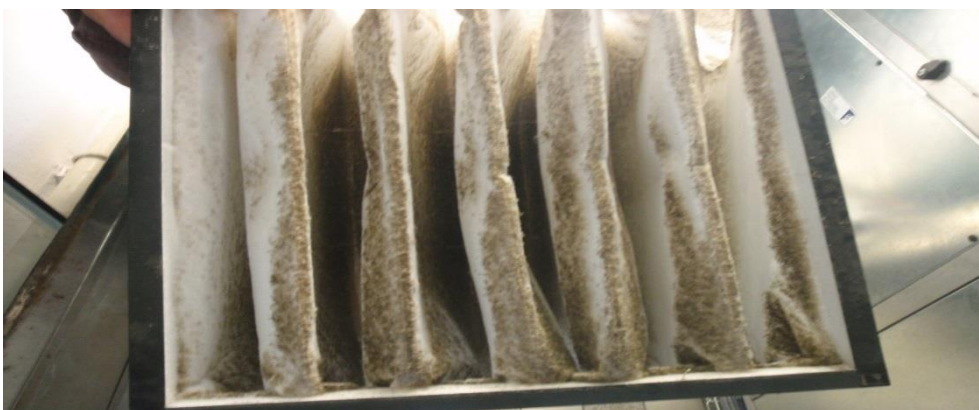
Obr. 5 Filtrační vložky po týdnu provozu, tzv. zabetonované
