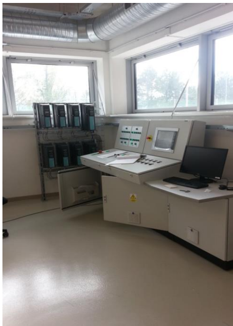
Obr. 9 Část řídicích systémů ventilátorových tratí
