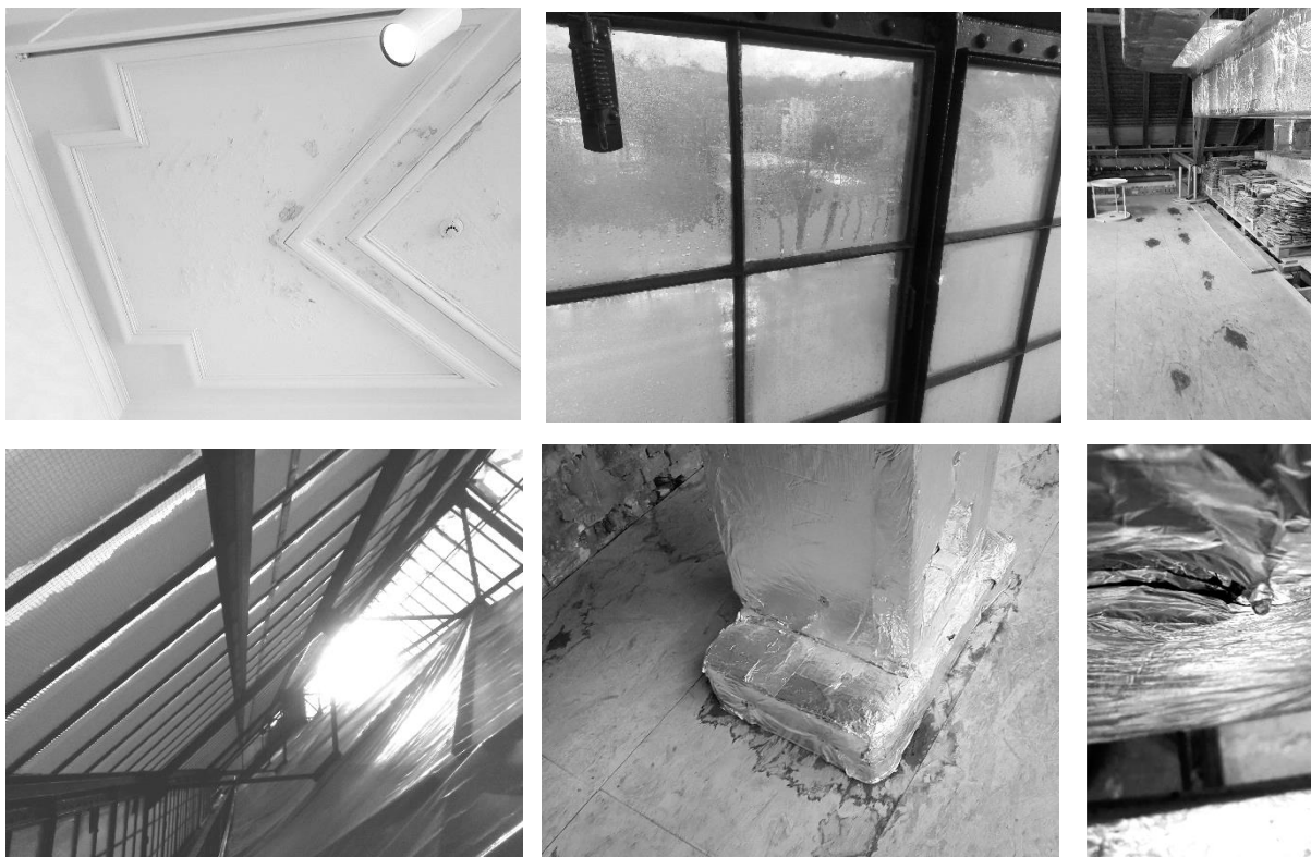
Obr. 3 Poškozená omítka stropu a nadměrná kondenzace vodní páry v prostoru podkroví.
