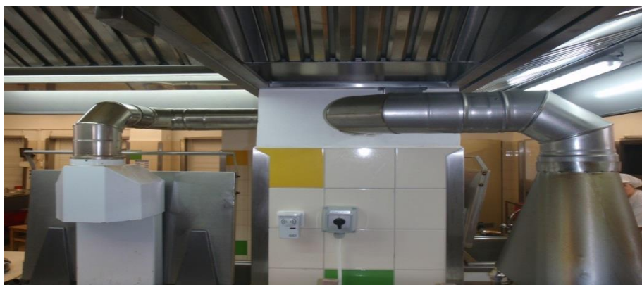
Obr. 6 Zaústění kouřovodů od plynových varných kotlů 150 l do komína – detail viz. obr. 7. Protispád kouřovodu, místo výšky min. 400 mm od hrany přerušovače tahu jen cca 150 mm.
